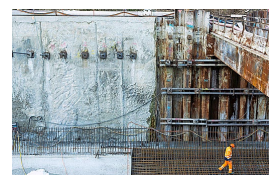
Infrastruktur: Der Tiefbau für Strasse und Schiene ist – nicht nur in der Schweiz – einer der wichtigsten Abnehmer von Stahl.
